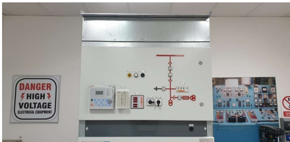
Slika 5.17 Upravljački istosmjerni krug prekidača
