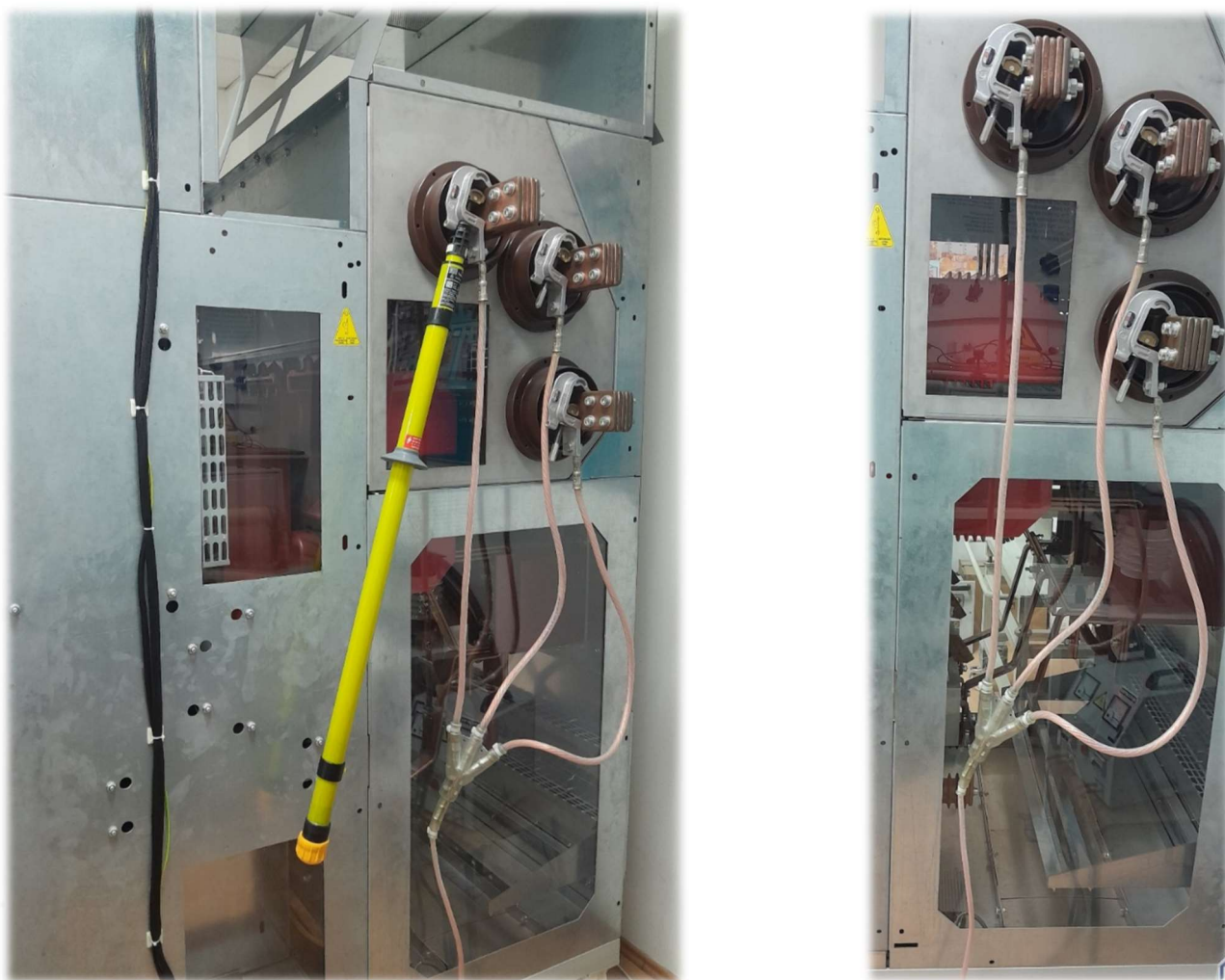
Slika 2.11 Uzemljivanje sabirnica prekidača KONČAR
